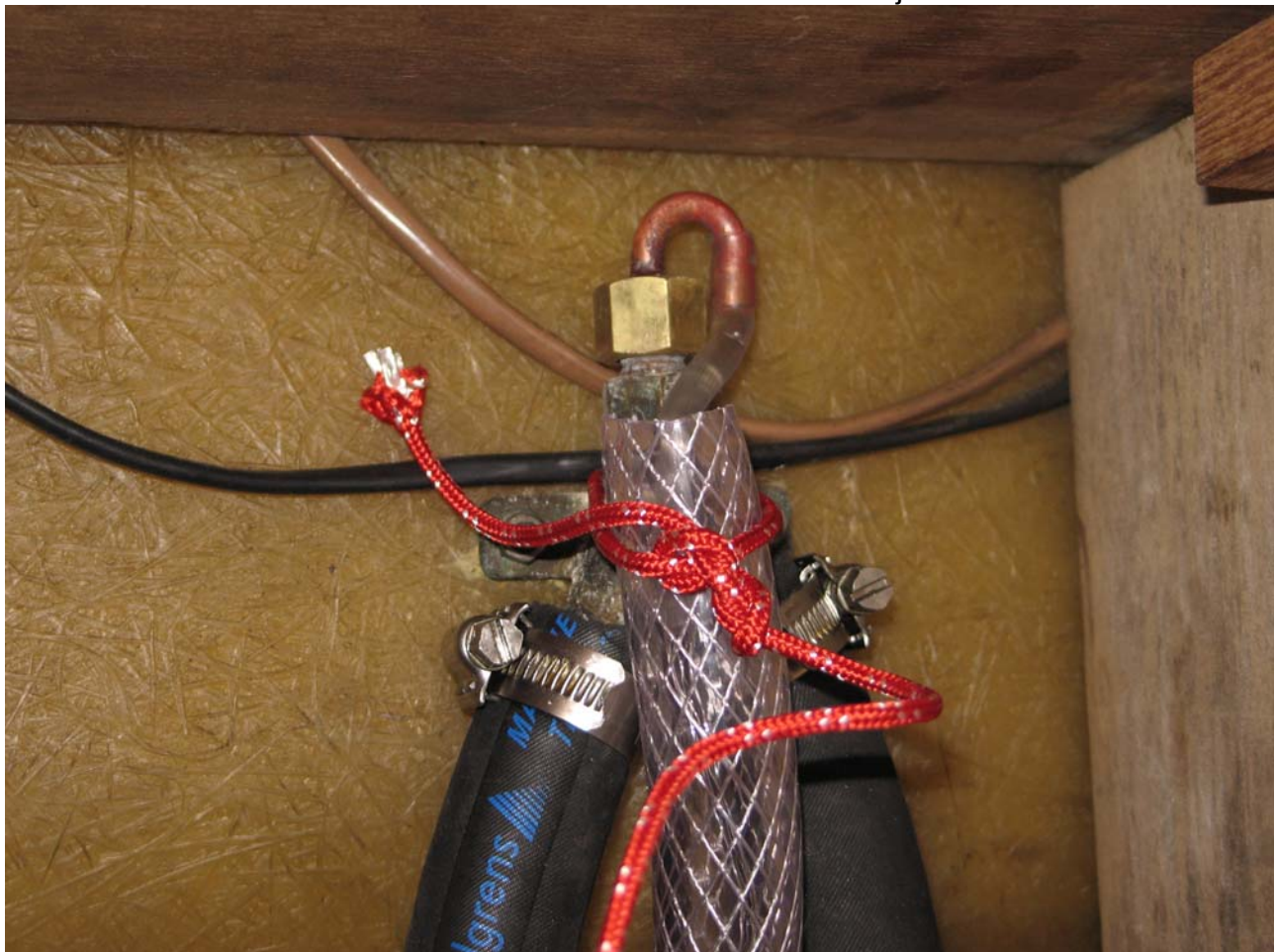
Bild 5.11, "ombyggd" vakuumentil i NF SWE 351
